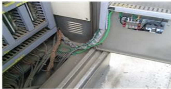
Nối đất bên ngoài cánh cửa tủ điều khiển
