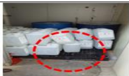
Chưa lắp đặt Trench chống rò rỉ
