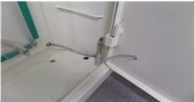
Nối đất bên ngoài cánh cửa tủ điện
