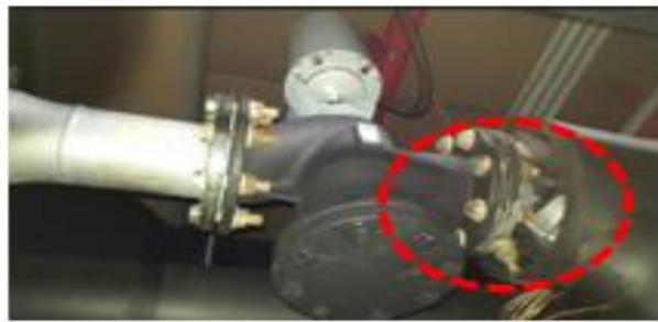
Bonding(tiếp địa) phân Bích của đường ống Gas
