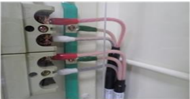
Nối đất phụ tải tủ điện
