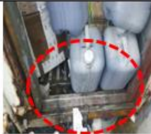
Chưa lắp Trench
